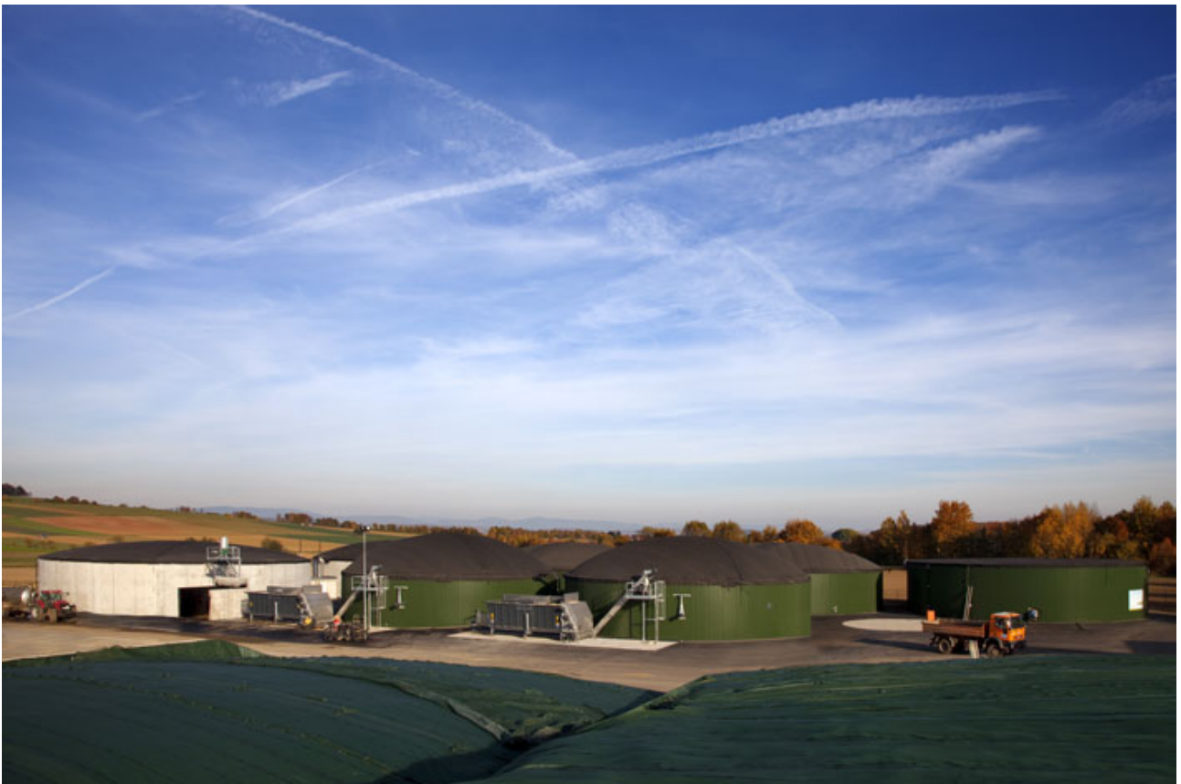
Bildquelle: Tom Baerwald. Biogasanlage Wollbrandshausen
