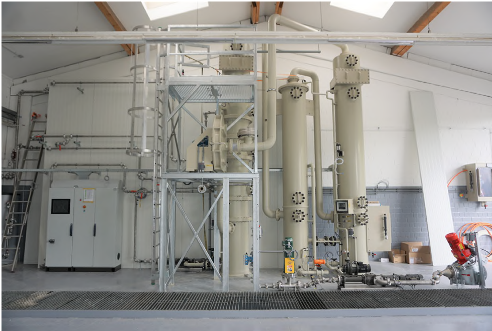
Abb. 1: Ammoniakstrippungsanlage der FH Münster (© FH Münster)
