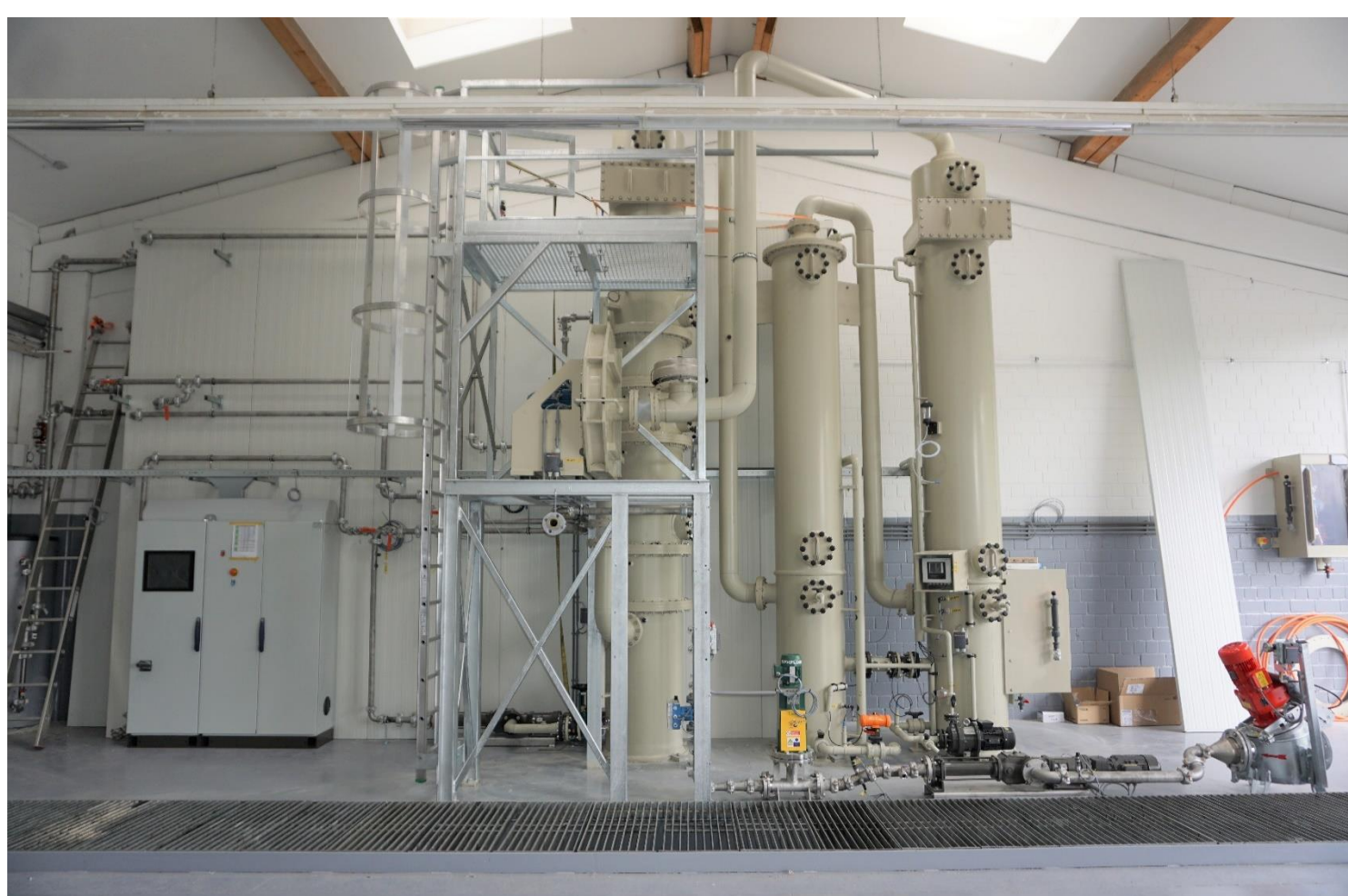
Abb.3: Strippungsanlage der FH Münster
