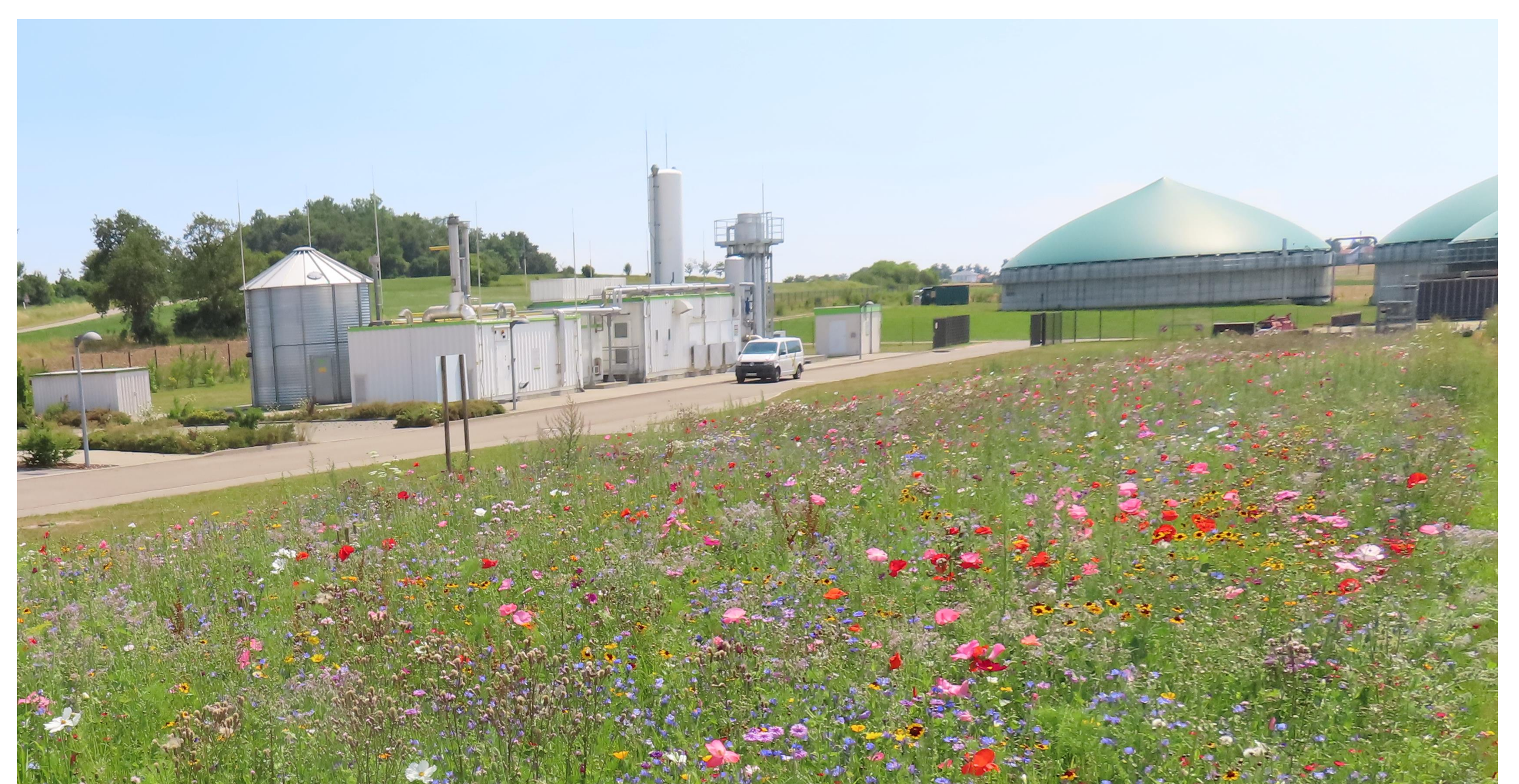
Biomethan-Aufbereitungsanlage (Quelle: Erdgas Südwest)
