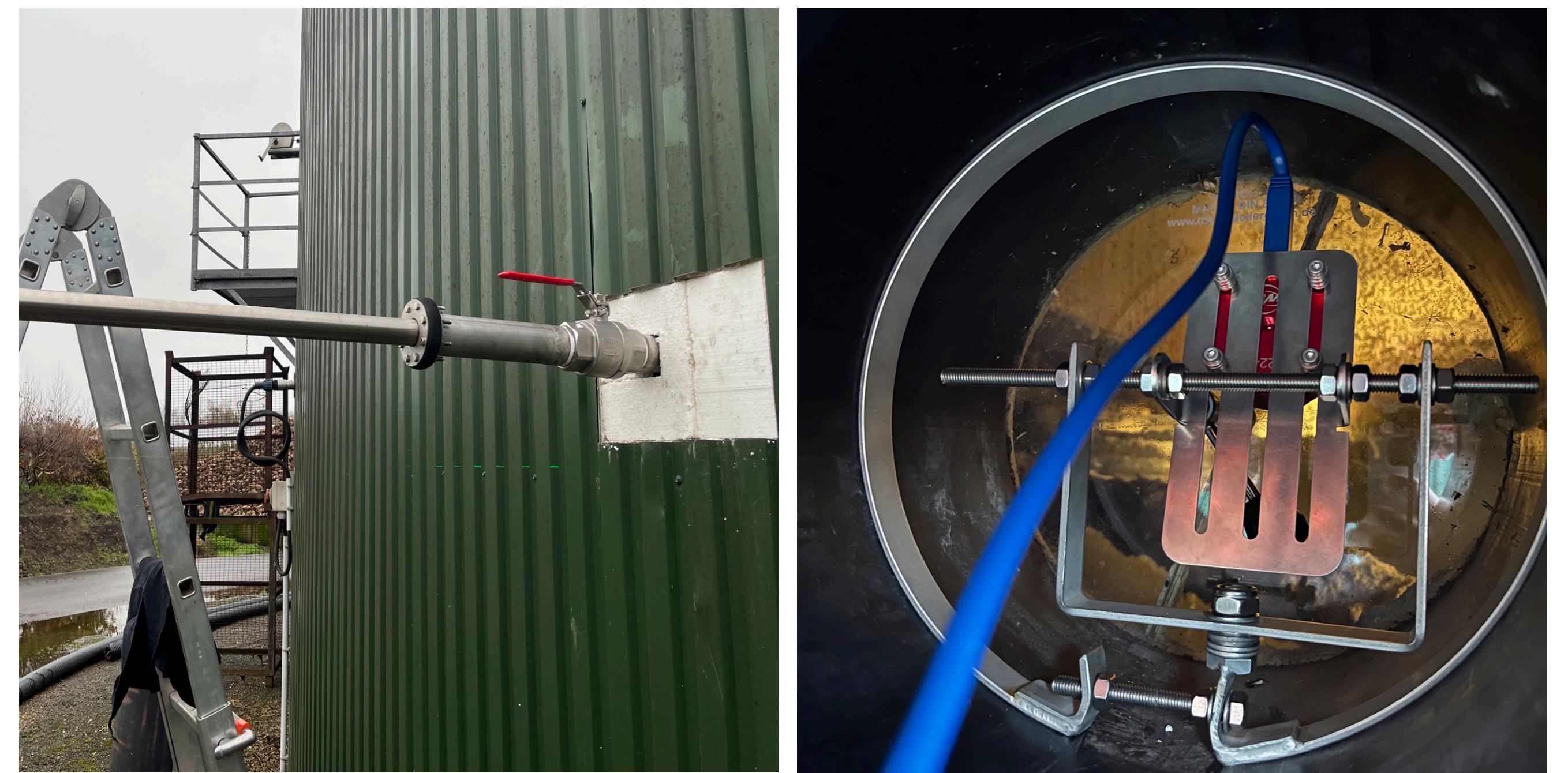
Abb. 2 Integration der beiden Messsysteme in einer Biogasanlage: Halterung mit Kamera in einer Fensteröffnung (rechts), WÜS-Lanze mit SPS-Schnittstelle (links)
